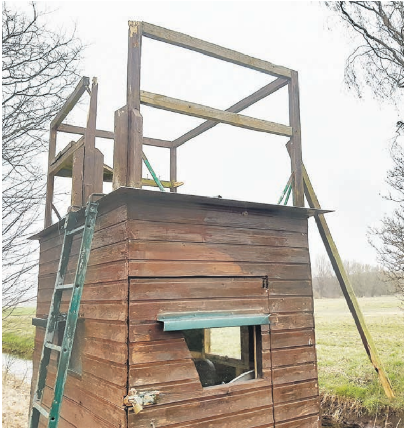
Der durch Vandalismus beschädigte Hochsitz der Rieploser Jäger.
