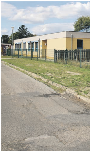
Die Theodor-Fontane-Straße ist stark von Schäden gezeichnet. FOTO: MARCEL GÄDING
