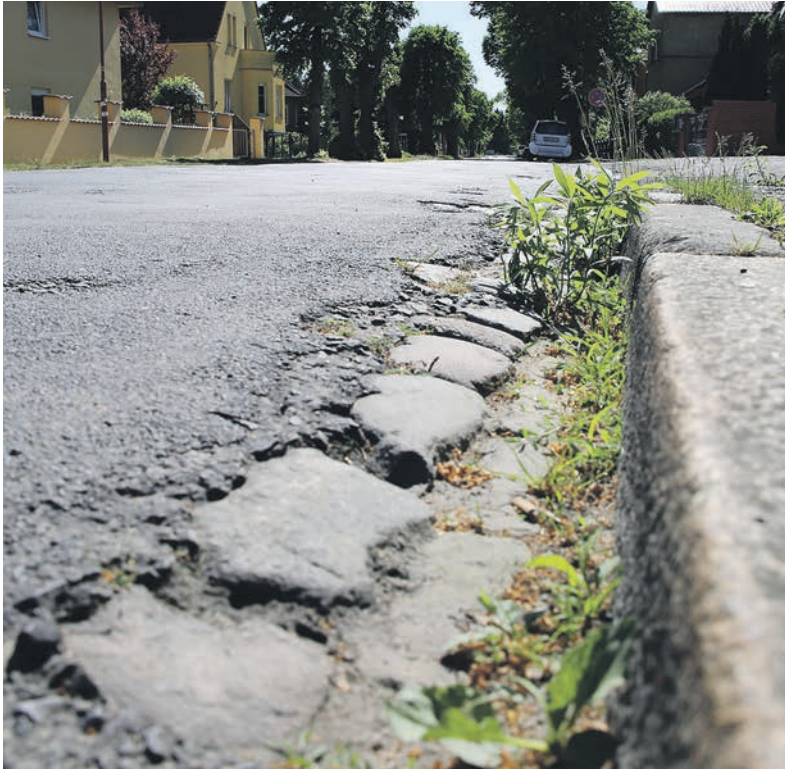
Die Gerichtstraße wurde in den vergangenen Jahrzehnten nur notdürftig geflickt. Jetzt steht die Sanierung an. FOTO: MARCEL GÄDING
