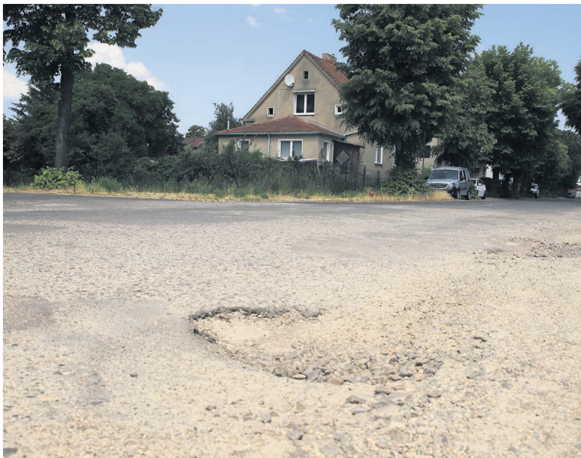
Blick auf die Kreuzung, an der Grasnicks- und Gerichtstraße aufeinandertreffen. Der Belag ist stark zerstört, überall gibt es Schlaglöcher.
