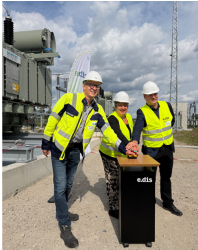
Hanjo During, E.DIS Geschäftsführer, Storkows Bürgermeisterin Cornelia Schulze-Ludwig und Oliver Kühne, Referatsleiter des Landkreises Oder-Spree, bei der Inbetriebnahme des neuen Umspannwerks in Storkow (v.l.n.r.). FOTO: F. MÜNN
